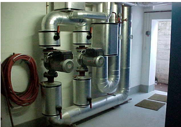
Fernleitungspumpen, 2 x 100% (Stör-/Zeitumschaltung)
