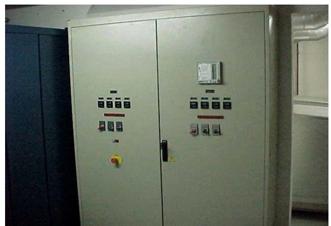
Schaltschrank mit Modemschnittstelle zum ATD
