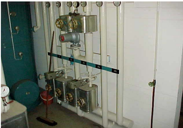
Unterstation mit Wassererwärmer
