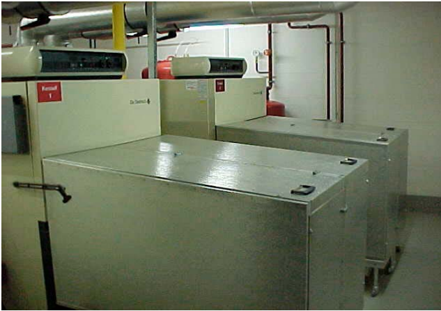
Wärmeerzeugung, 2 Oel-Gaskessel De Dietrich à 440 kW
