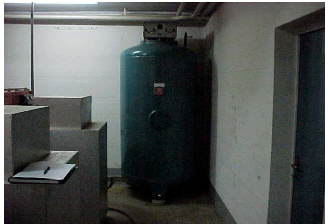
Expansionsanlage SVTI Pflchtig
