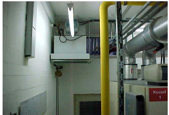
Oel - Förderanlage (Saugpumpe)
