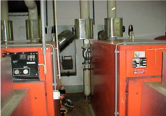
Wärmeerzeugung, 2 Oelkessel Strebel à 535 kW
